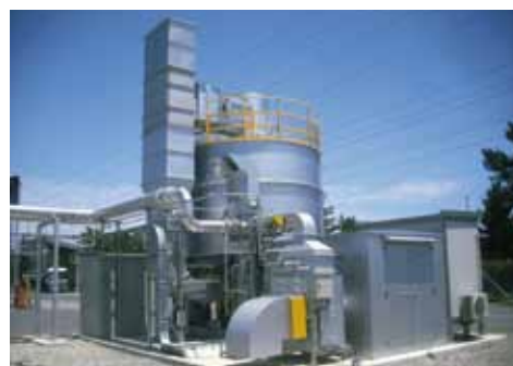
鹿島工場VOC処理装置
