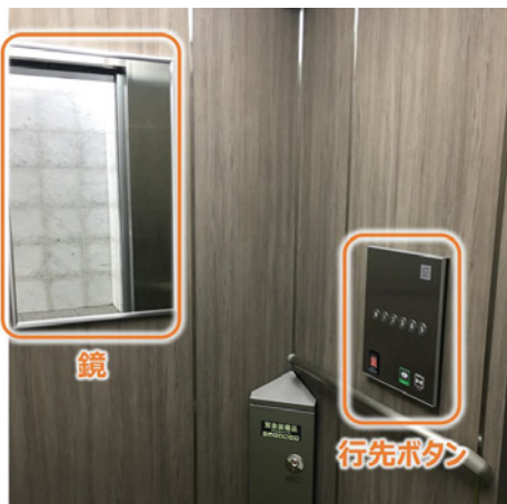
エレベーター
